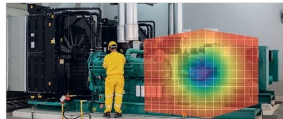
Generatoren, Aggregate, Elektroanlagen
